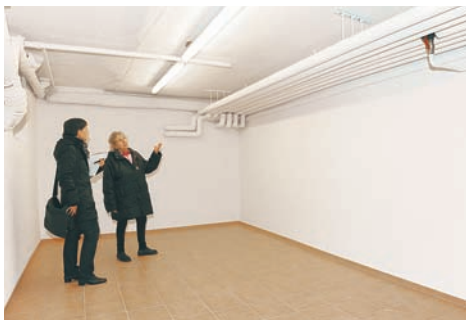
Im Heizkeller stand früher ein Tank, der 12.000 Liter Heizöl fasste - nun wird hier bald Tischtennis gespielt ...
